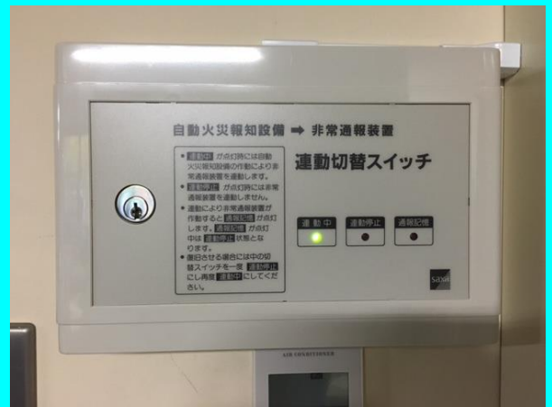
火災報知設備→非常通報装置 連動切替スイッチ
